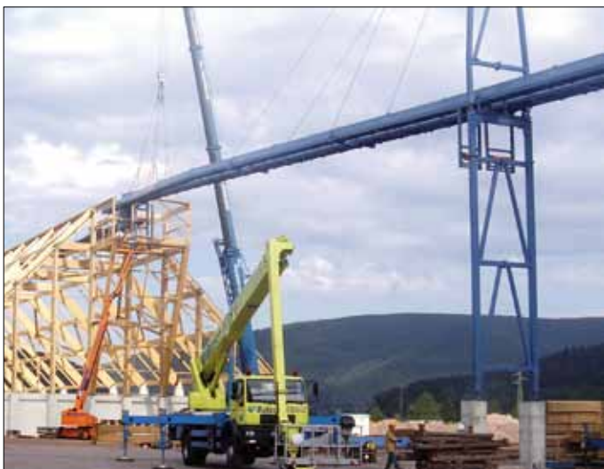
Transportören i position
